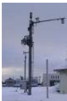
Estación meteorológica en la carretera
