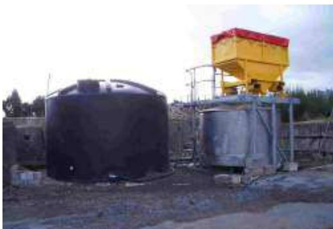
Station de mélange d'ACM
