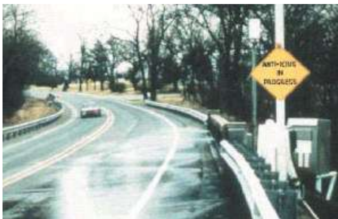
Sistema fijo de aspersión de anticongelante (Fotografía cortesía de CRYOTECH Deicing)
