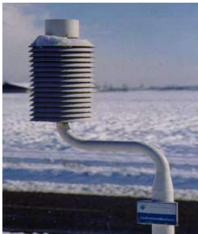
Partie d'une station SMR le long d'une route
