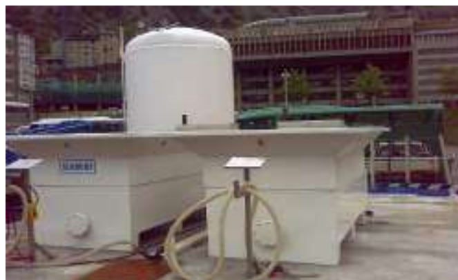
14.- Station de production de saumure
