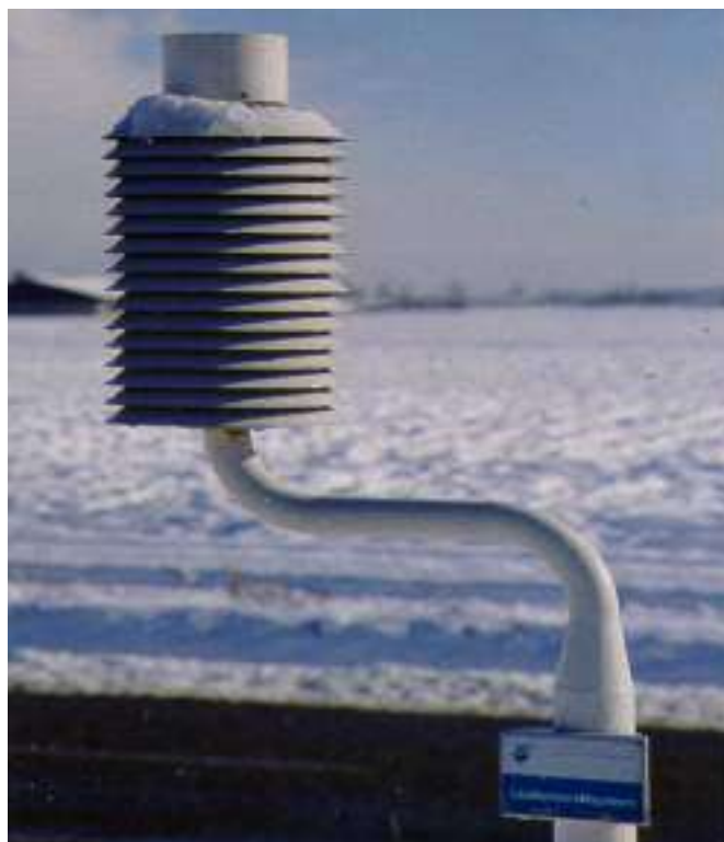
Parte de un RWIS en margen de carretera
