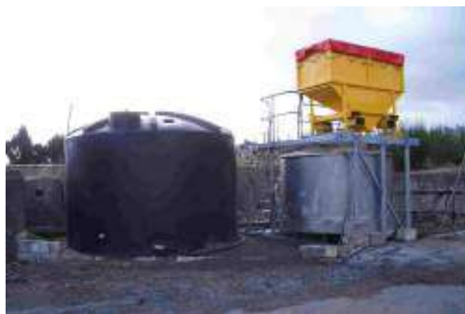
Planta de mezcla de ACM
