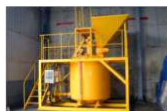
Instalación de salmuera de cloruro cálcico
