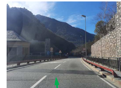
Junta reparada ( chicle )
